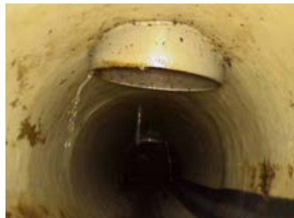
Figura 5.1.1 Allaccio che entra nel collettore di fognatura: difettosità locale da sistemare
